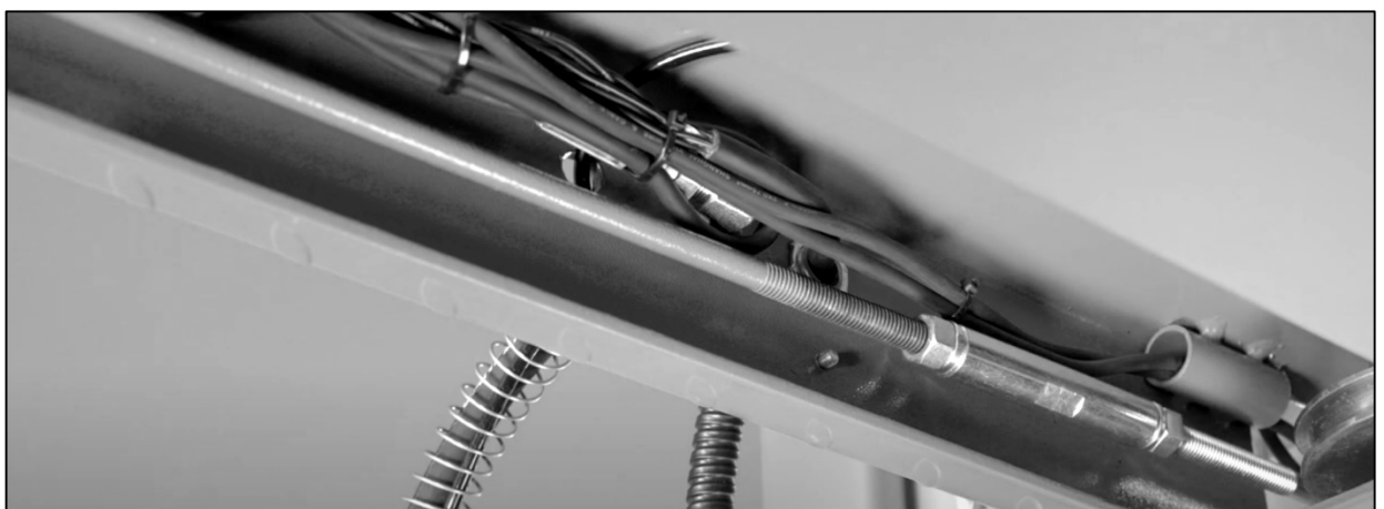
Abbildung: Kabel unter Fahrbahn
