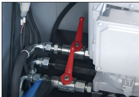
Abbildung: Kugelhähne Betriebsstellung
